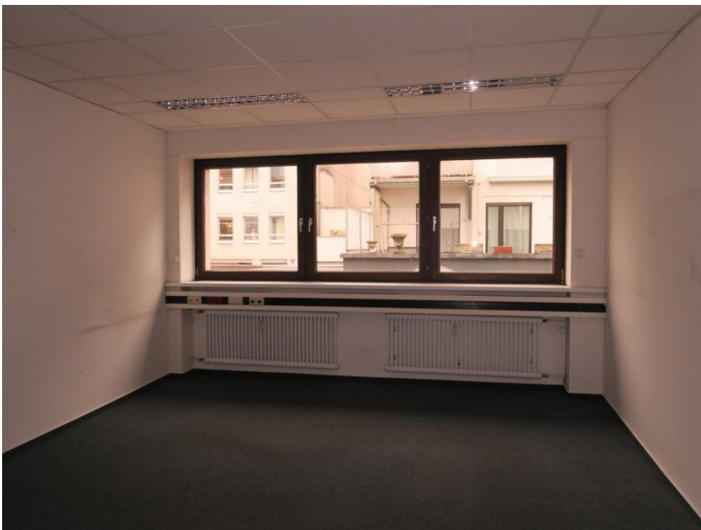
Zustand der Wohneinheiten vor Nutzungsänderung
